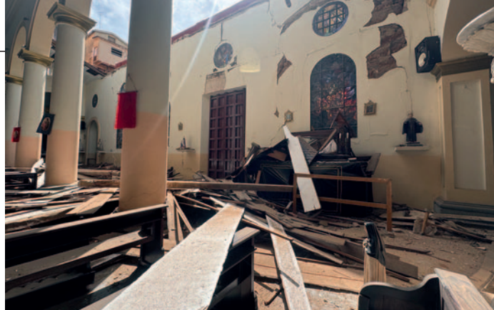
L'église San José de Ñaraulí à Caracas après les tremblements de terre du 24 juin.
